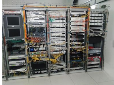
▼ BAIE DE BRASSAGE TELECOM PAM PRO
